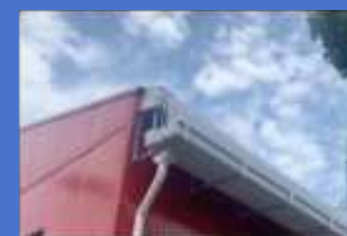
排水槽Drainage grooves
